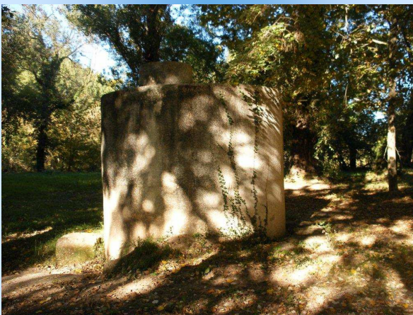
Puits de forage Station de pompage de Cazouls d'Hérault
