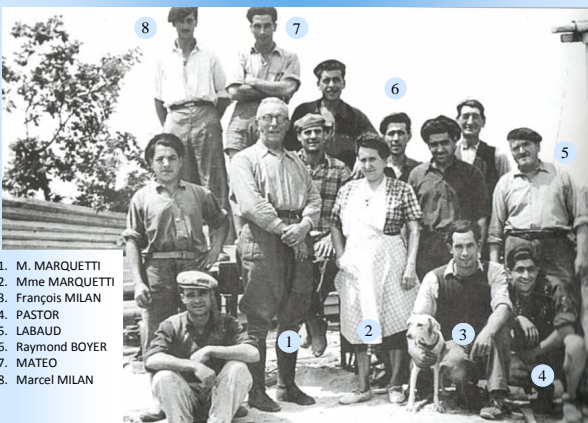
De mai à août 1951 construction du bassin d'alimentation d'eau de la Vallée de l'Hérault.
